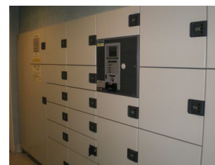
図11 宅配ボックス
